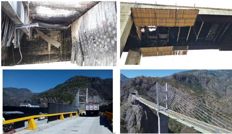
Figura 3.2: Puente El Carrizo: área dañada y de rehabilitación.
