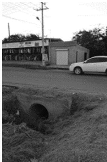
Figura 10. Ausencia y/o mal estado y equipamiento sobre la vialidad.
