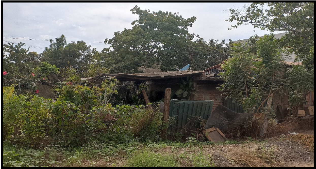
Figura 21. Vivienda inadecuada localizada en la colonia Loma de Rodriguera
