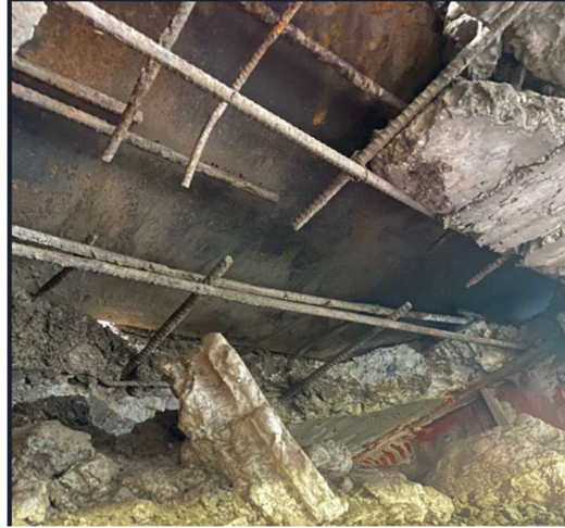
Figura 35.- Acero expuesto en losa de Puente Miguel Hidalgo.
