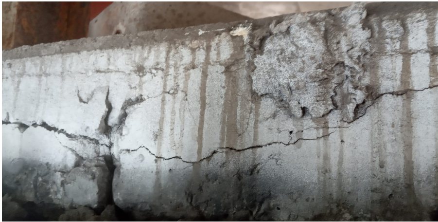
Figura 4.7: Imagen de muestra: Superficie de concreto con grieta en puente Miguel Hidalgo.
